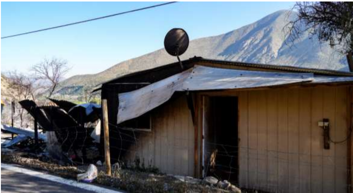
Ilustración 39 Registro de vivienda afectada por incendio Colliguay-Chaguaral, 4 de octubre 2025.
