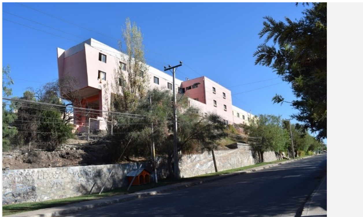
Fig. 22. Liceo Eduardo Frei Montalva de Monte Patria afectado en el terremoto de 2015
