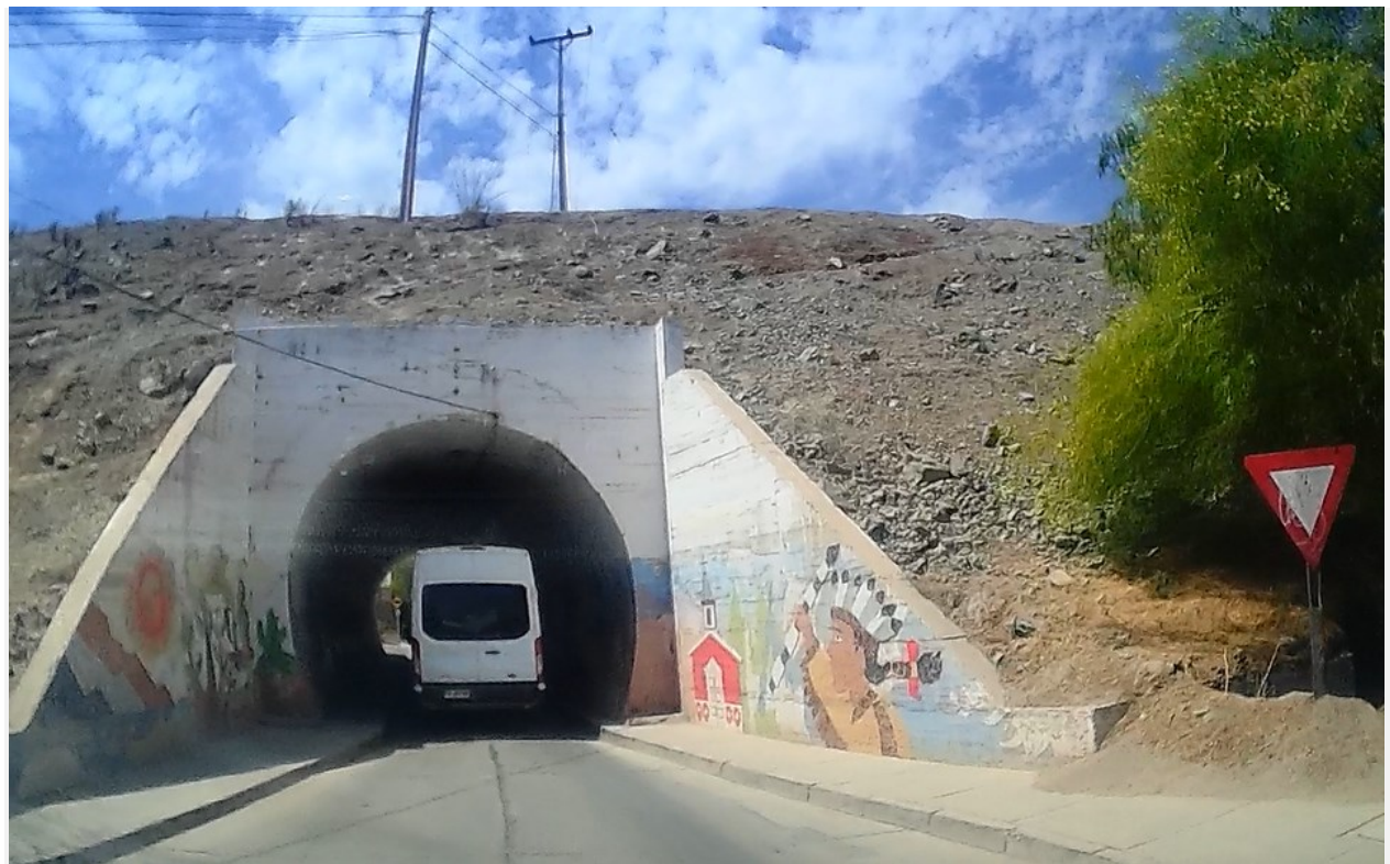
Fig. 40. Túnel vial ubicado en calle Arturo Pratt, Localidad de Monte Patria Fuente: Archivo fotográfico Consultor, 2022
