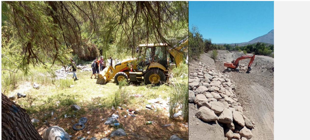
Fig. 31. Intervenciones sin regulación en borde río y en sector humedal del Río Grande. Carén 2020 y 2022
